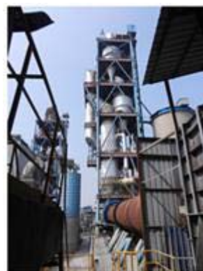
图 2-52 烟气脱硝示范工程
