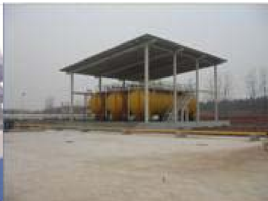
图 1-51 液氨储存区图
