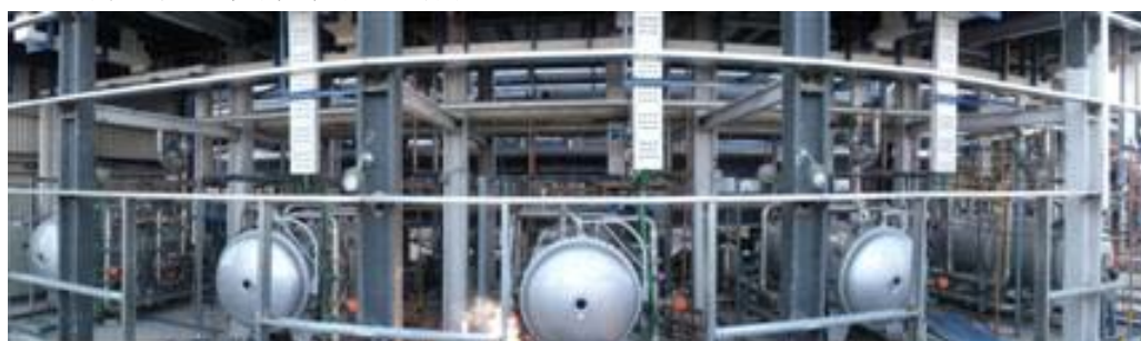
图 2-67 5 套 55kg/h (空气源) 臭氧发生器全貌照片
