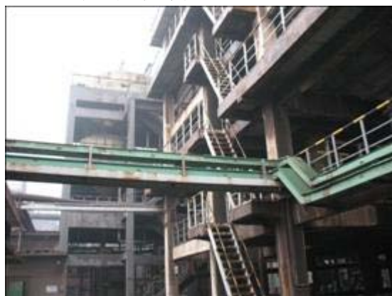
图 2-40 案例现场预处理系统装置
