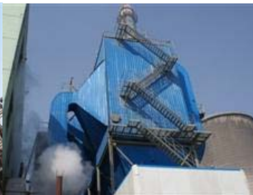
图 1-102 除尘器运行图
