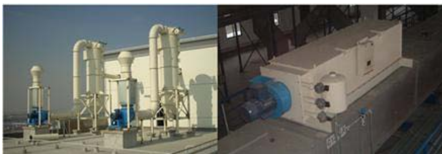
图 6-16 除尘系统配套的除尘器
