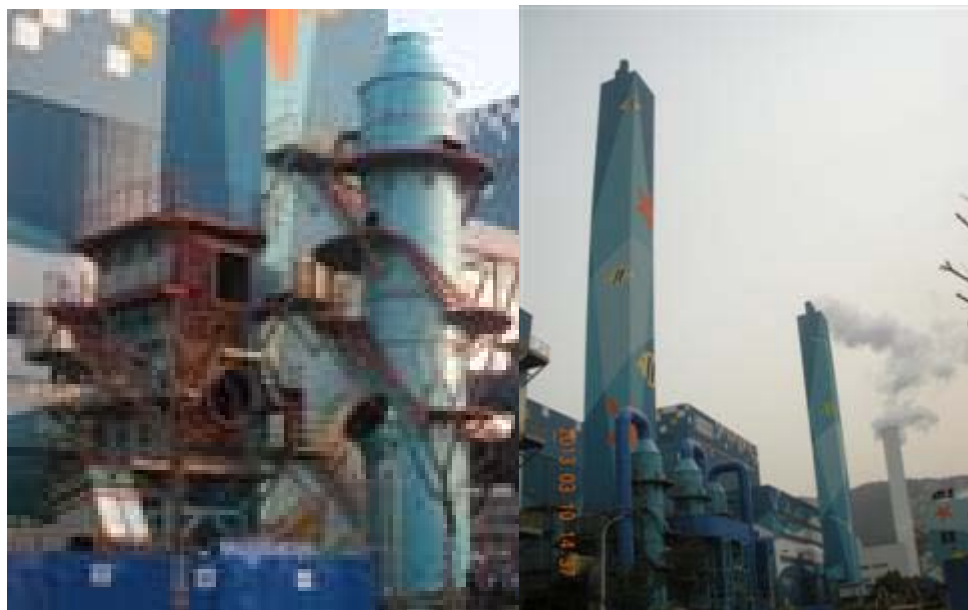
图 3-50 换热器及洗涤塔图 3-51 脱白系统运行效果对比照片
