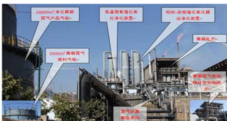
图 3-53 黄磷尾气净化用部分成套设备
