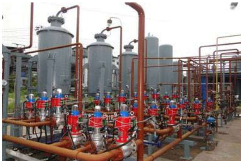
图 2-84 变压吸附提纯装置
