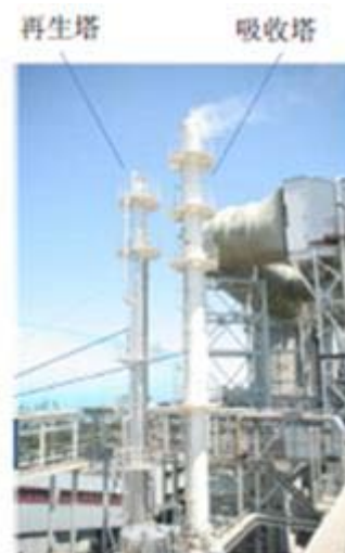
图 1-127 吸收塔和再生塔图
