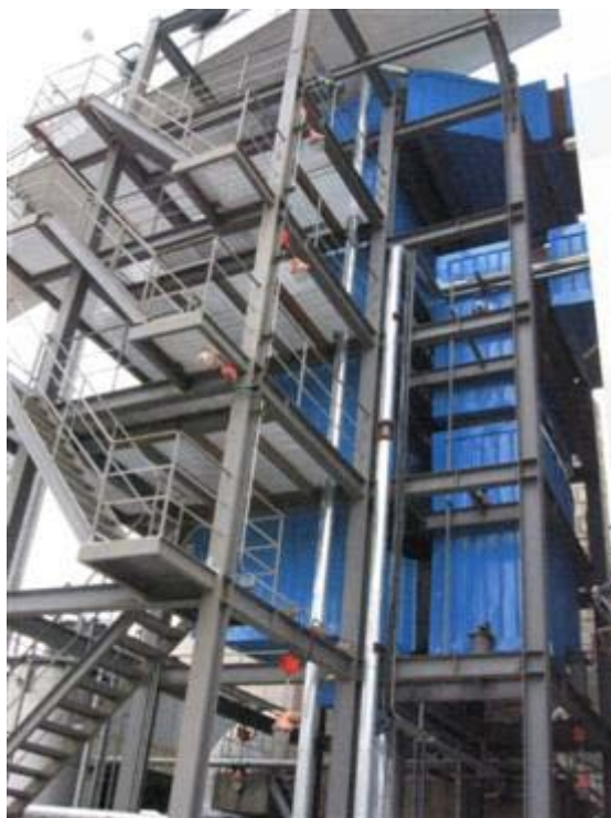
图 2-42 工业锅炉 SCR 烟气脱硝示范工程
