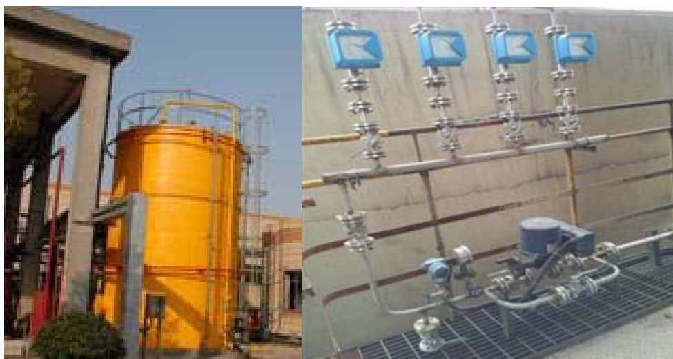
图 2-48SNCR 脱硝系统氨区图 2-49SNCR 脱硝炉前系统
