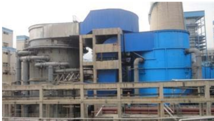
图 1-9 案例双回路吸收塔现场图
